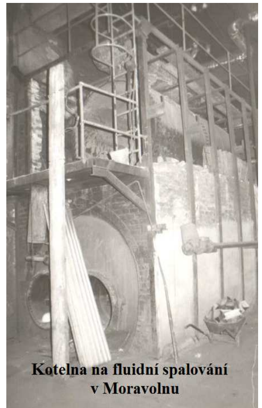
Kotelna na fluidní spalování v Moravolnu
