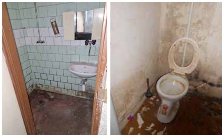
Hygienické zázemí v některých bytech staré panelové zástavby
